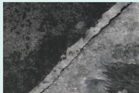
Fig - 4 - Detalhe de trinca em reparo
